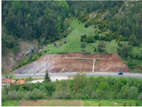
Fig. 19. Estado inicial talud
